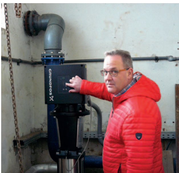
Die Themen Energieeinsparungen und Ressourceneffizienz haben bei Vossen hohe Priorität – man schaut eben in jede Ecke, wo Energie verbraucht wird. Sich auch die Pumpen anzuschauen lag auf der Hand (Renè Pal, technischer Leiter bei Vossen – hier im Bild mit einer neuen CR-Hocheffizienzpumpe von Grundfos zum Fördern des Rohwassers).
